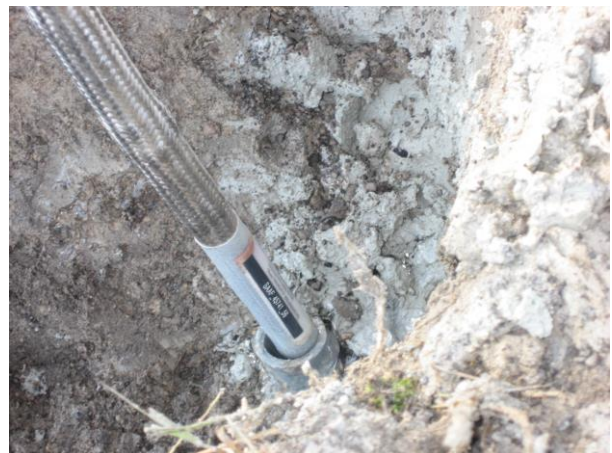
Figur 3.9b Installation av deformationskabel (SAAF). (Från Cautus Geo AS 2013).
