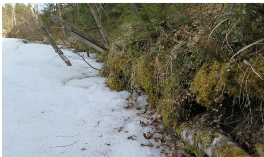
Figur 66 Erosion på grund av isrörelse Granö, Umeälven (Foto: P. Danielsson, SGI).
