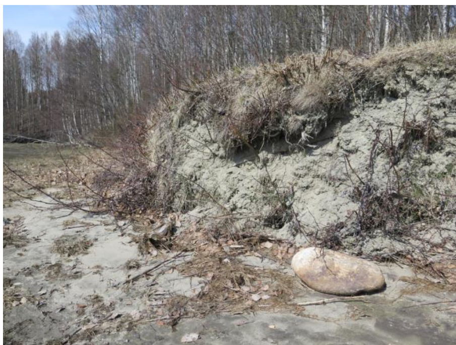
Figur 67 Erosion på grund av isrörelse Vindeln, Umeälven (Foto: P. Danielsson, SGI).
