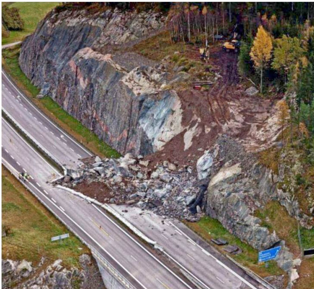
Figur 13. Vid det oplanerade raset under arbetet med kompletterande förstärkning 2011, var körfältet närmast berget avstängt, men däremot inte det andra körfältet. Rasmassorna på bilden innefattar både det som föll ut i samband med sprängning och det som rasade strax efter. Foto: Trafikverket.
