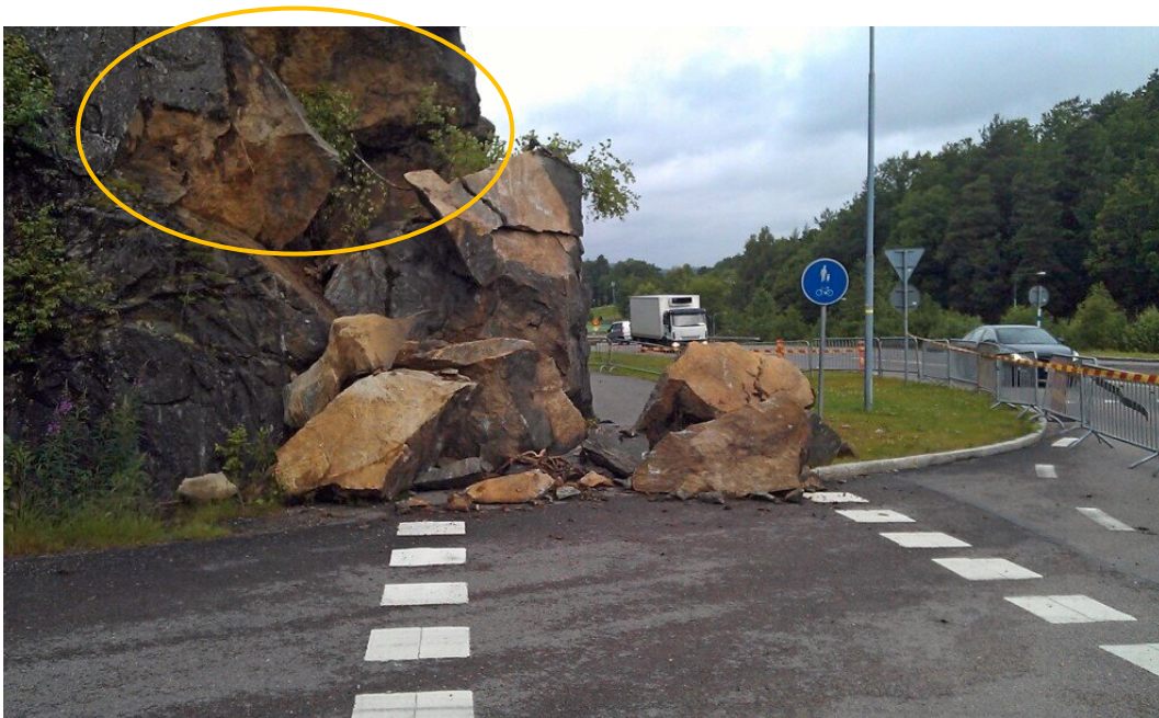
Figur 16. Första raset, 2012. Åt vänster i bild går en mindre infart till parkeringsplats och panncentral. De övre delarna (gulmarkerat) rasade 2015. Foto: Partille kommun.
