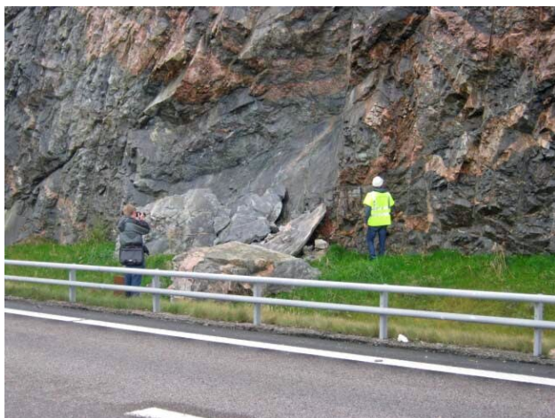
Figur 12. Mindre ras som initierade besiktning och efterföljande, omfattande entreprenad. Foto: Trafikverket.
