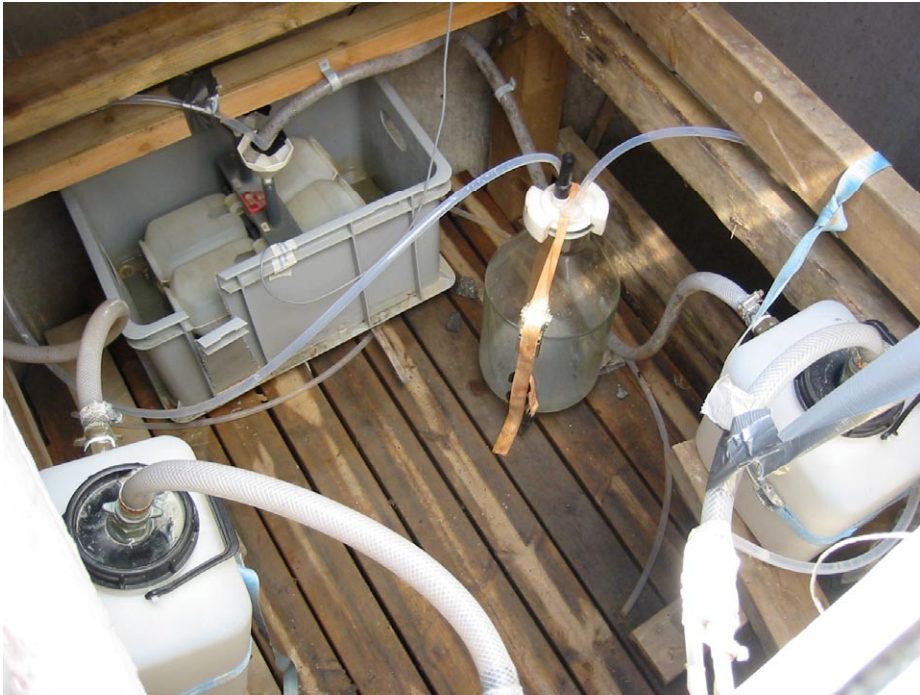
Figr 3.4. Installerade uppsamlingskäril och vippflödesmätare i en uppsamlingsbrunn.
